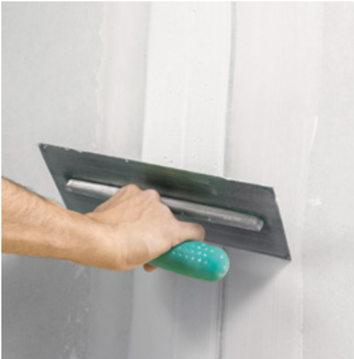
... und dann der Längsfuge entlang ziehen und sogleich mit der Traufel ablängen.
